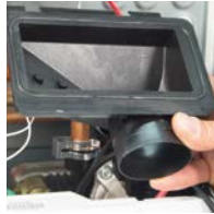
Ispezione raccolta condensa
