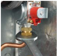
Rimozione del sistema di serraggio sulla valvola gas
