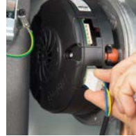
Disconnessione elettrica ventilatore
