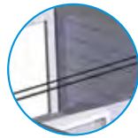
Tubazione del refrigerante
