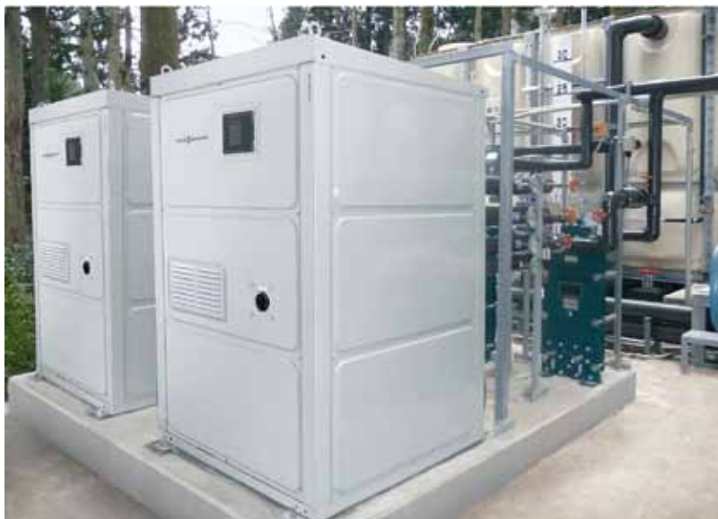
Riscaldamento acqua di processo con il calore di recupero come fonte primaria
